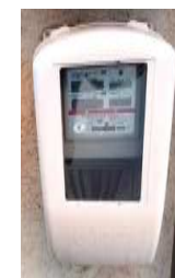
電気メーター
