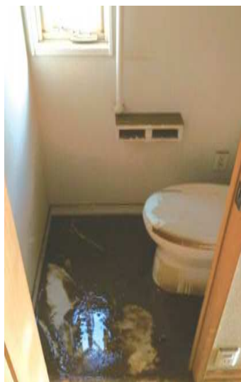
浸水したトイレの様子
