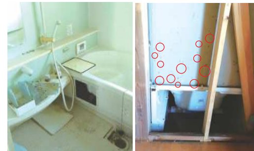
壁裏に発生したカビ
