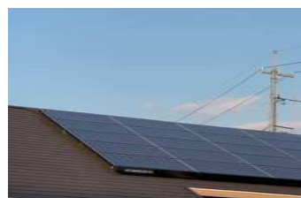
太陽光パネル
