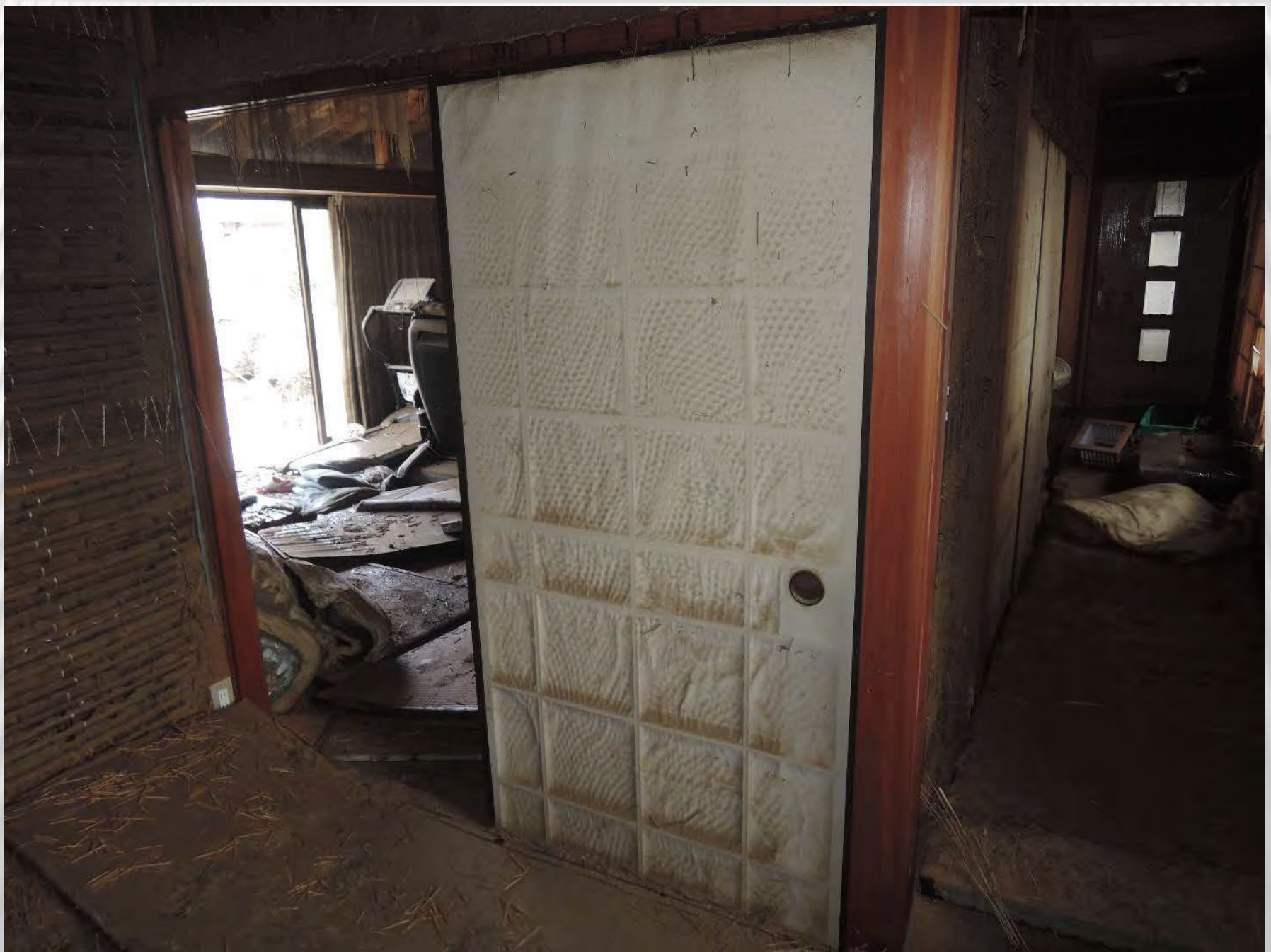
浸水深度の深い地域（2階まで浸水 3.5メートル程度）
