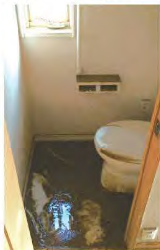
浸水したトイレの様子
