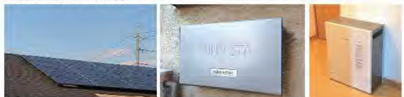
太陽光パネル
