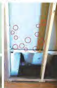
裏側に発生したカビ
