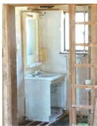
浸水後の洗面台
