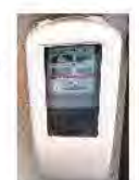
電気メーター
