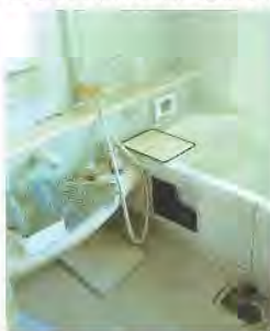
浸水したユニットバス
