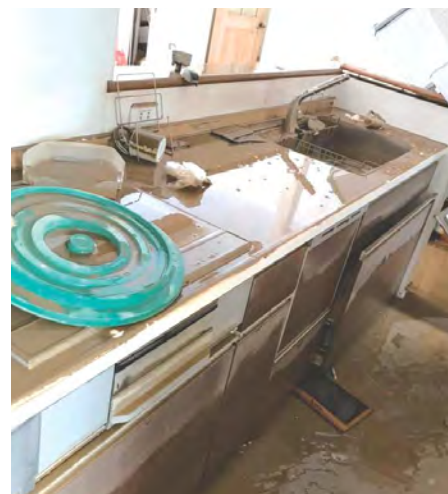
浸水したシステムキッチン
