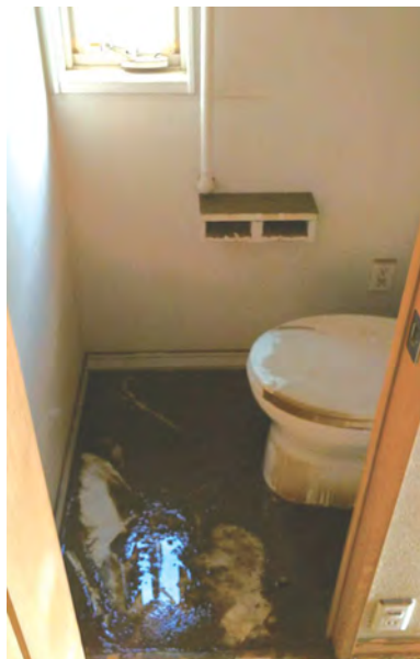
浸水したトイレの様子
