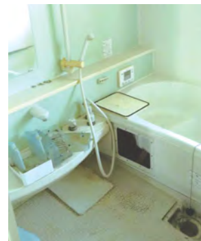
浸水したユニットバス
