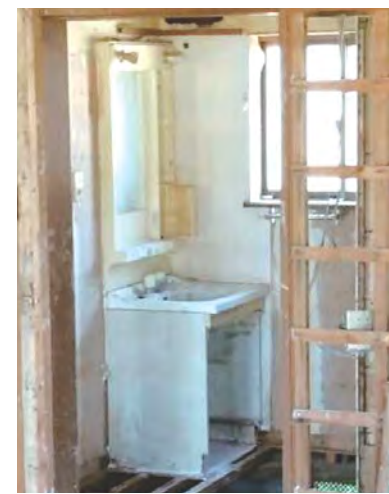
浸水後の洗面台
