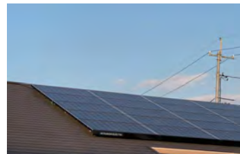
太陽光パネル
