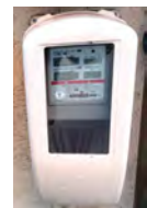
電気メーター
