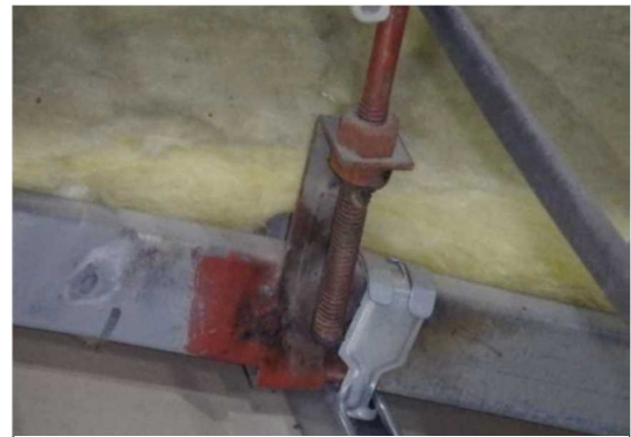
天井地下材の錆
