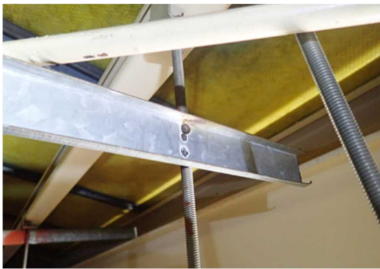
天井地下材の錆
